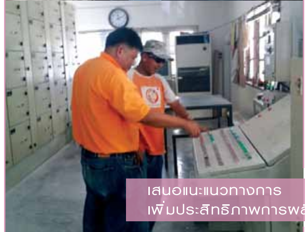
ตรวจสอบอุปกรณ์ในห้องควบคุมไฟฟ้า
