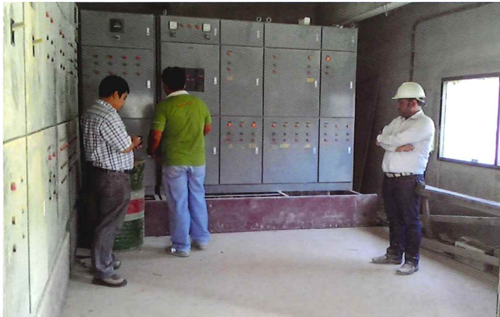
การตรวจสอบอุปกรณ์ในห้องควบคุมไฟฟ้าของโรงโม่หิน
