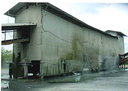
ระบบปิดคลุมอาคารโรงไม่หิน
